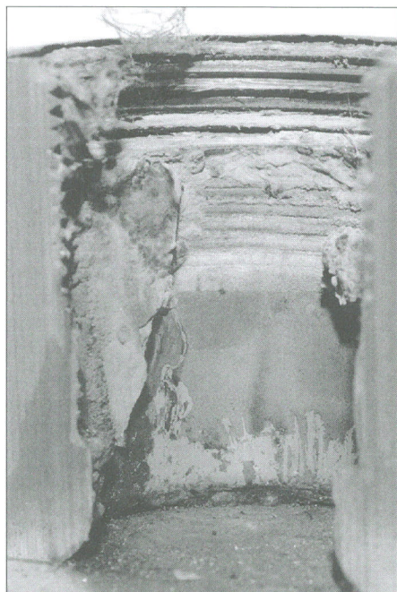
Bild 1: Korrodierte, gehaftte Verbindung Fig. 1: Hemp-packed joint
